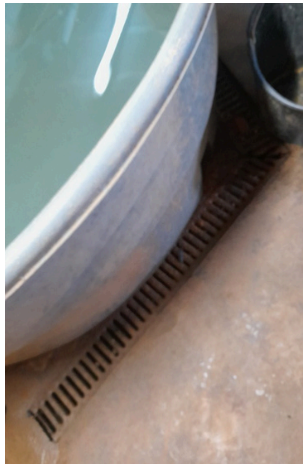
évacuation au sol au pied du bac de lavage
