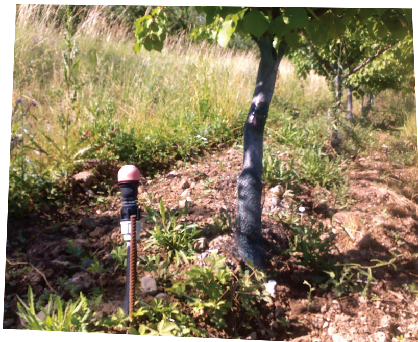
UNE INSTALLATION EN GOUTTE À GOUTTE ENTERRÉ : SEULE LA FIN DU TUYAU EST VISIBLE
